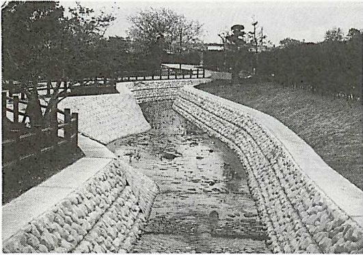
図12 改修された小水路 (1999. 4. 11). 河川改修に当たっては生き物に配慮するよう建設省が通達を出して10年近くが経つが、相変わらずこのような工事が行われている。見た目を良くしただけの完全な3面コンクリート護岸である。
